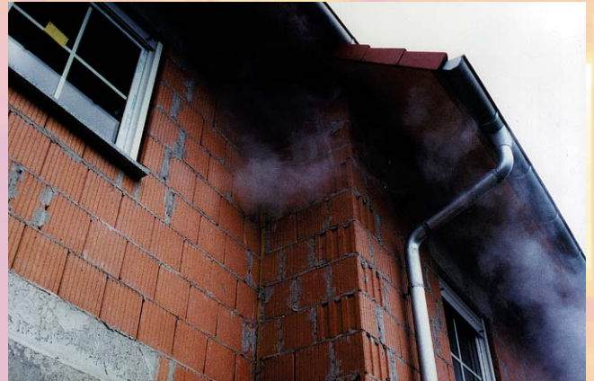
Abb 6 Detailaufnahme einer aufgefundenen Schwachstelle.
